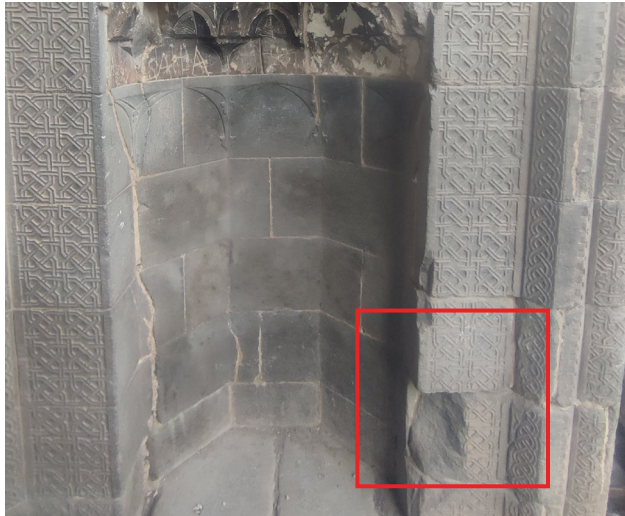
Şekil 3.10 : Melik Ahmet Paşa Cami taç kapının doğu ayağında yer alan nişte meydana gelen parça kopması hasarı (Düzenleyen: Hakseven, 2024).
