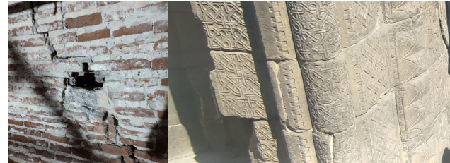
Şekil 3.8 : Melik Ahmet Paşa Cami kubbesinde ve taç kapının doğu ayağında meydana gelen kırılma hasarları (Düzenleyen: Hakseven, 2024).
